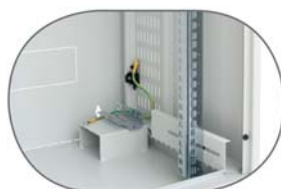
KABLING - SEKSJON 12U
